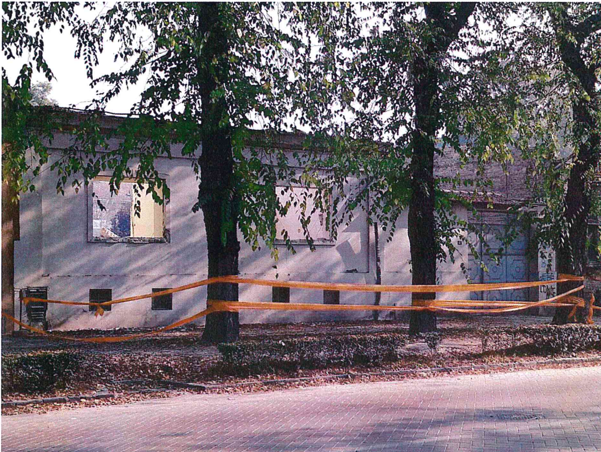
Објекат под бројем 41 који се руши у оквиру ПКИЦ Улица Браће Радић у Суботици (28.10.2019)
