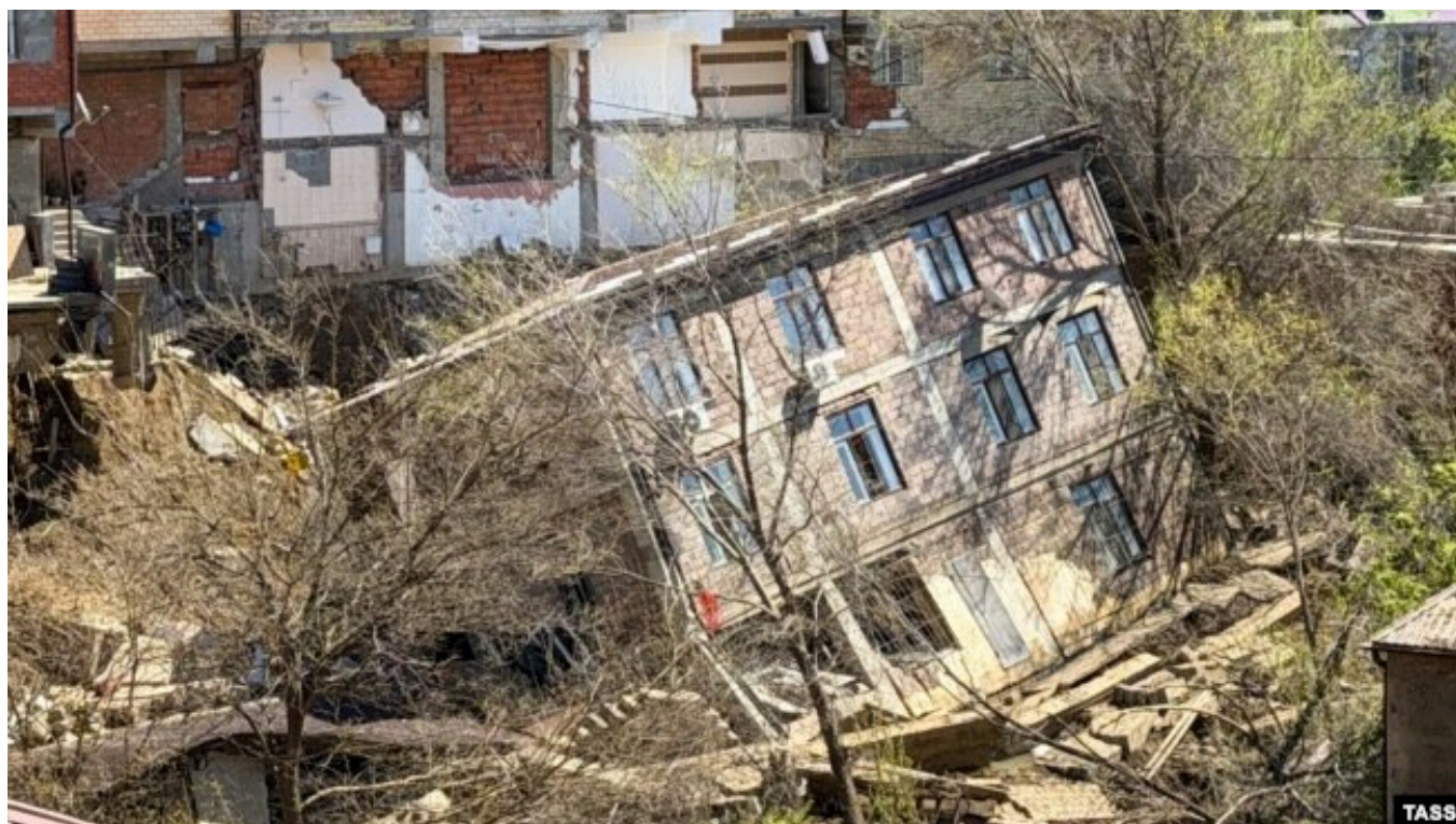
Разрушенный во время наводнения дом в Махачкале. Апрель 2026 года
