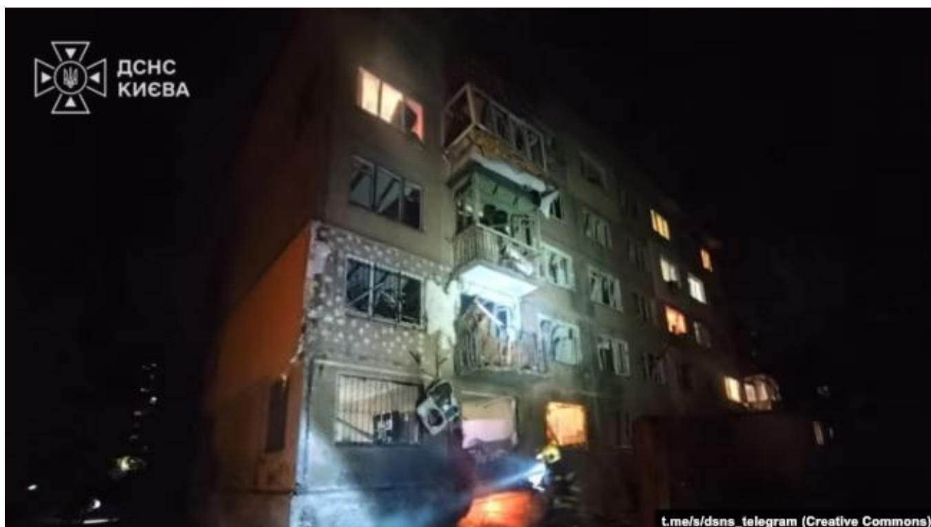
Повреждённый жилой дом в Киеве
