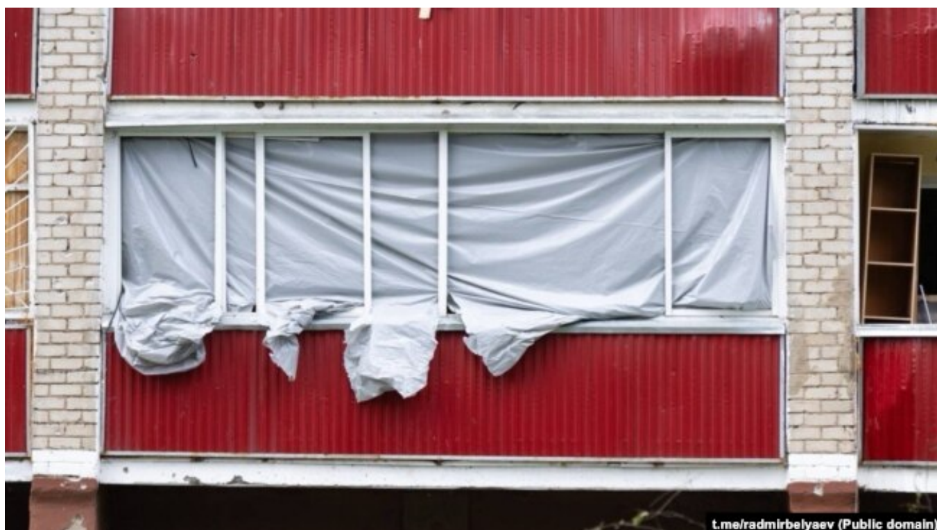
Поврежденный дом в Нижнекамске. 10 августа 2026 года
