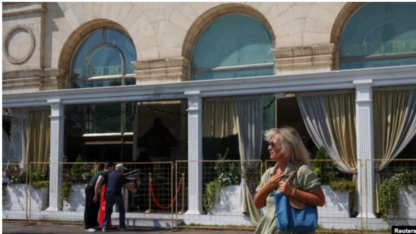
Помещение ресторана, поврежденное взрывом
