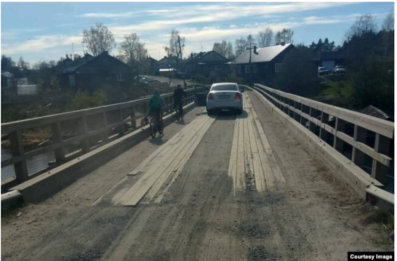
Обветшавший мост через реку Янисйоки
