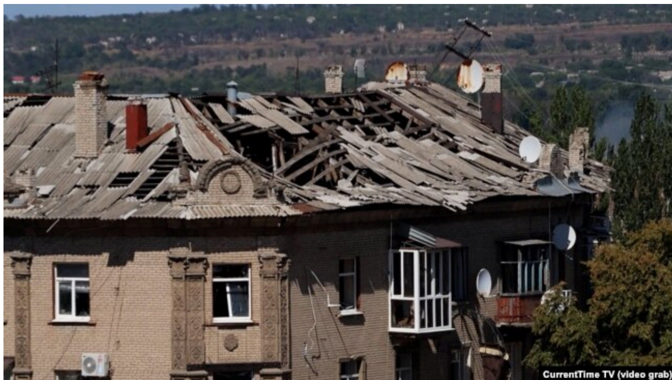
Разрушенные дома в Константиновке.
