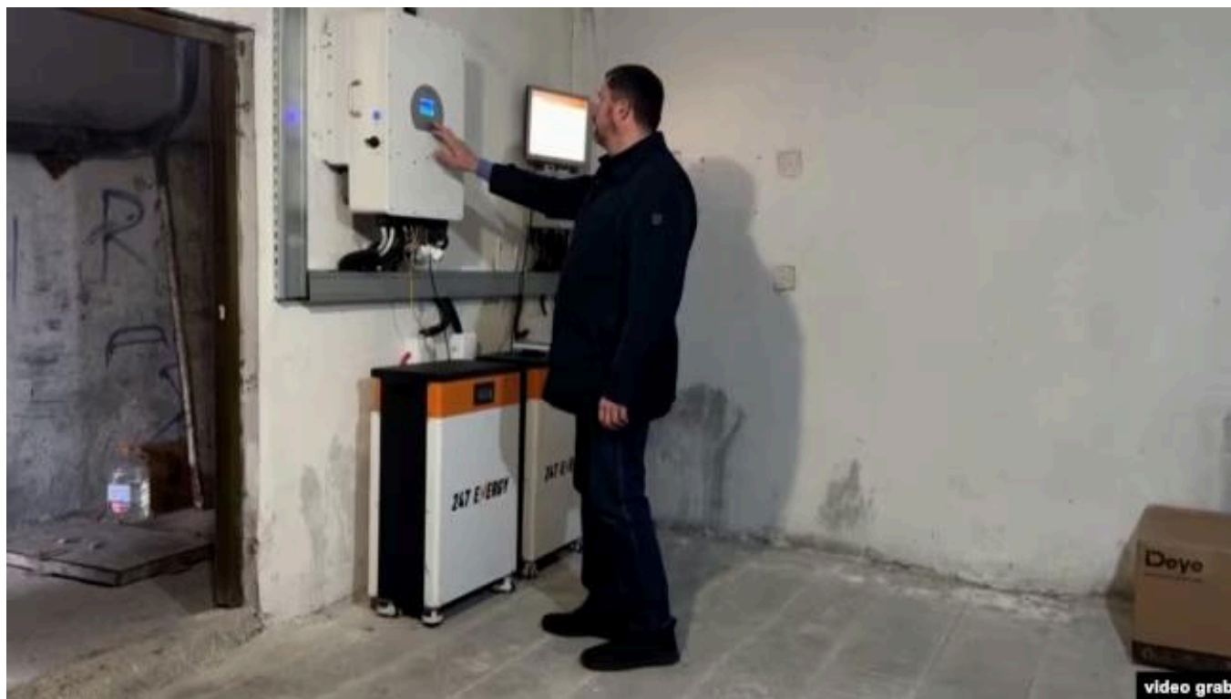
Батарейный модуль помогает сохранять энергию
