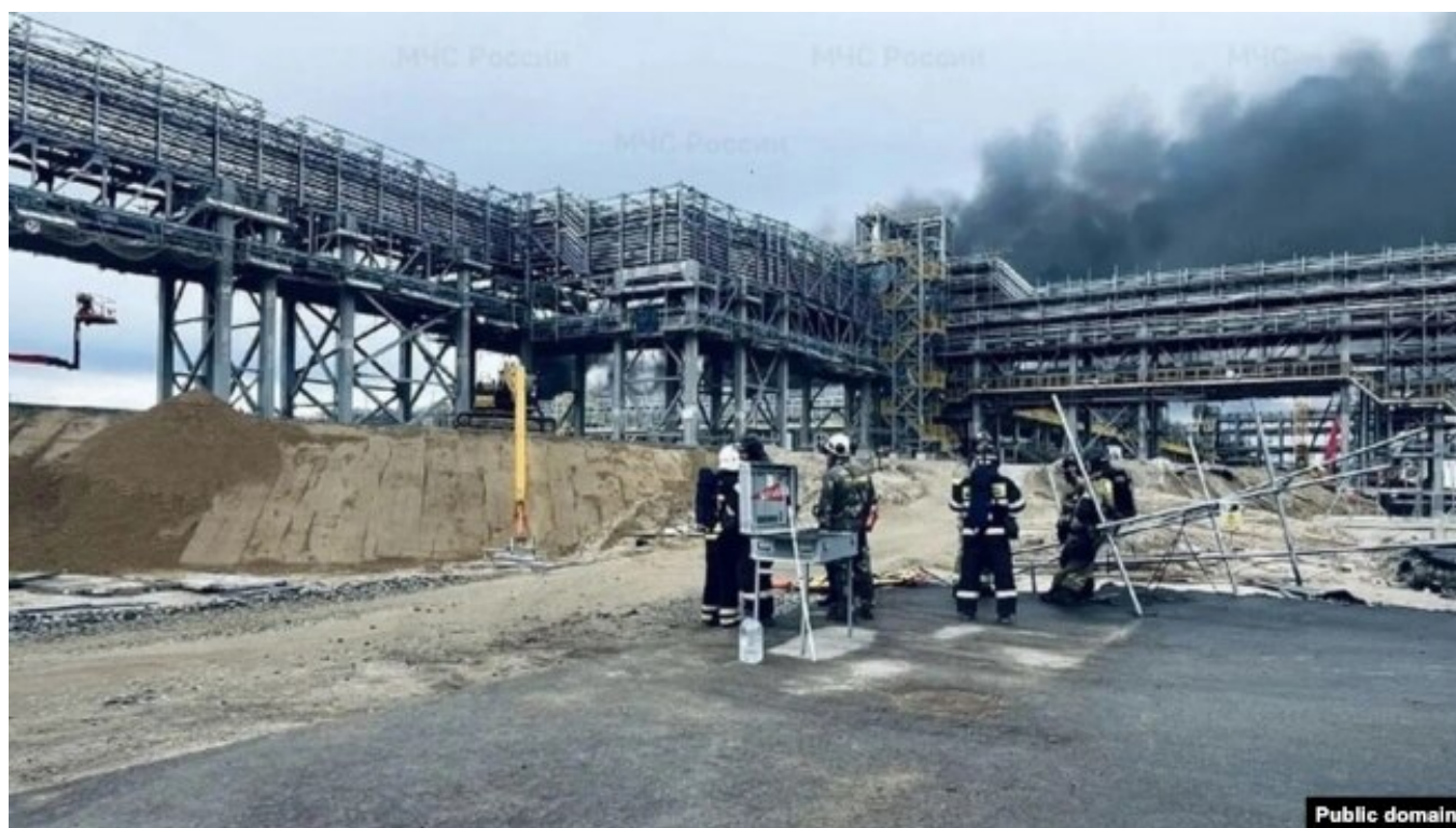
Площадка газохимического завода "Амурский" после пожара
