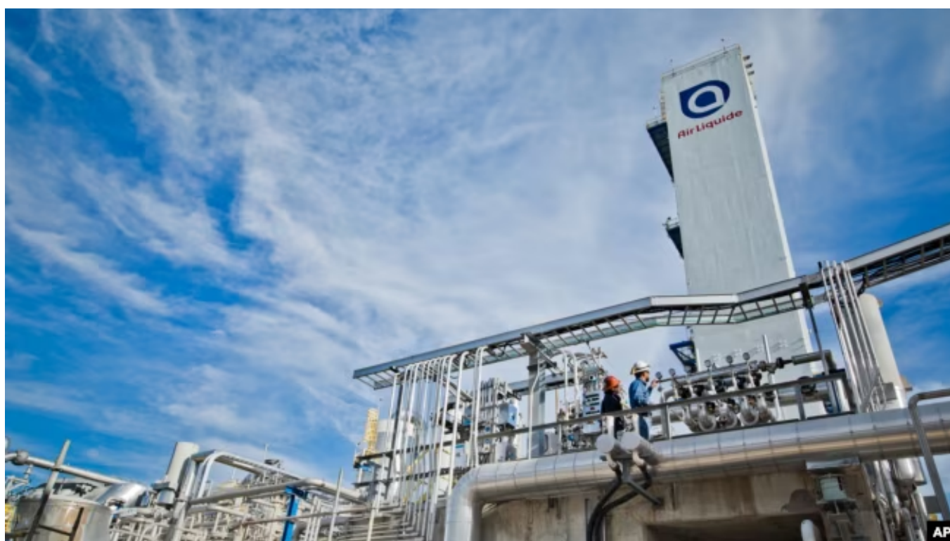
Производственные установки Air Liquide в Лонгвью, штат Техас
