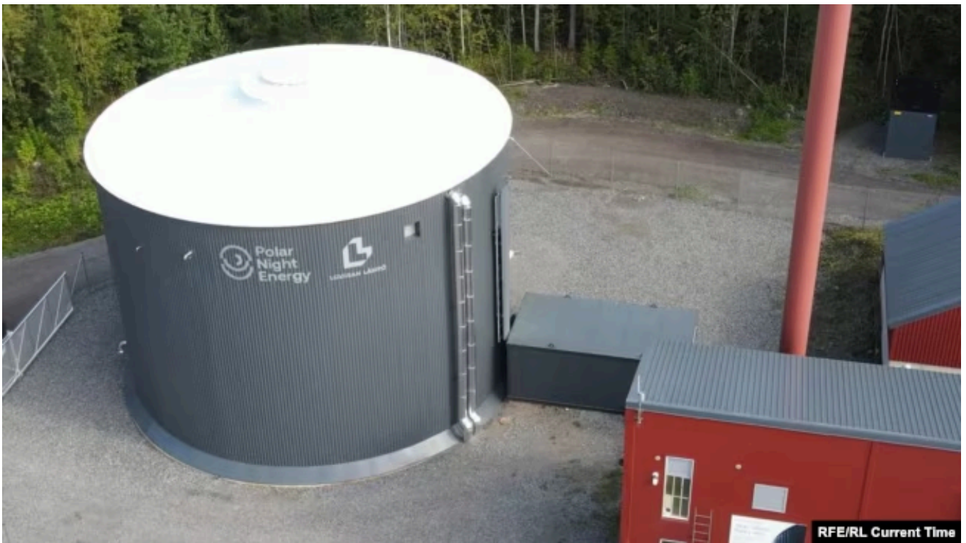
Вид песочной батареи сверху
