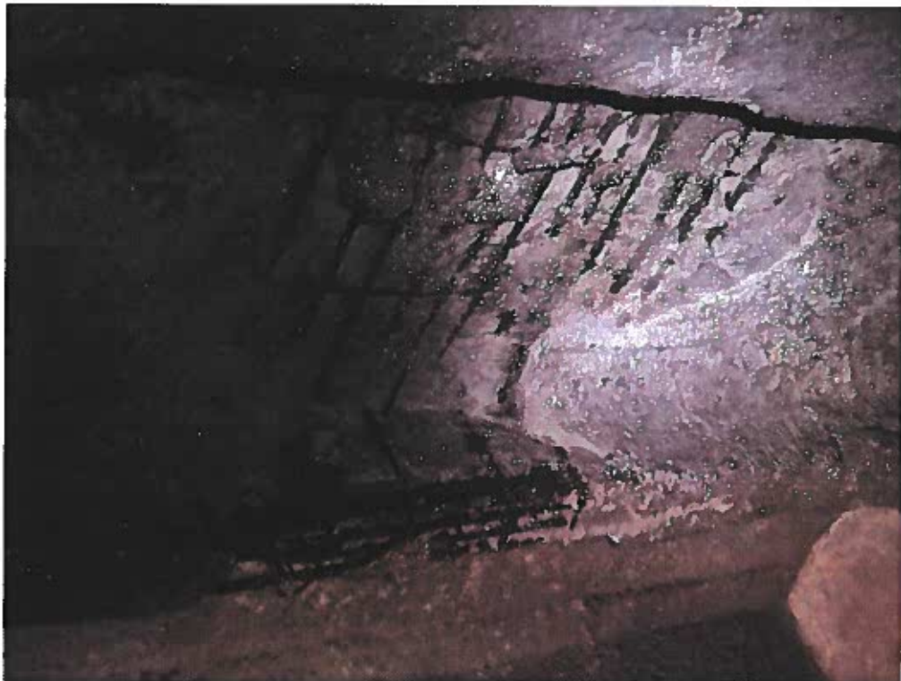
Foto 16. Degradări severe ale betonului din grinzi și din placa de planșeu
