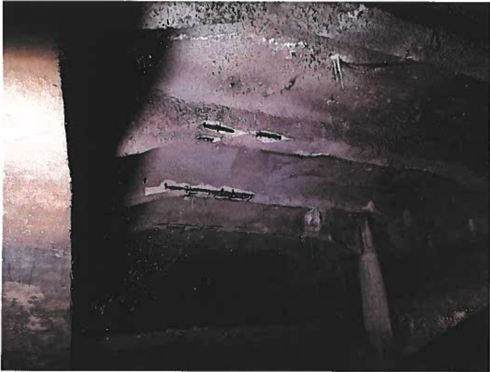
Foto 19. Degradări severe ale betonului din grinzi și din placa de planșeu. Armături dezvelite și corodate, cu reduceri ale secțiunilor barelor
