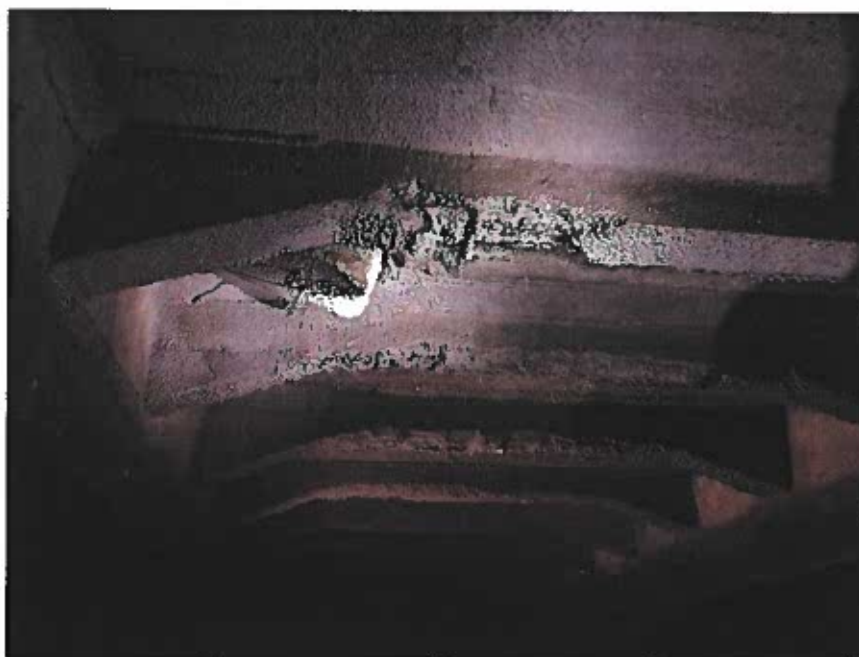
Foto 10. Grinzi care au fost reabilitate prin torcretare. Ruperi ale betonului din grinzi pe zonele de mijloc, între vute. La reparațiile precedente nu au fost refăcute secțiunile grinzilor, torcretul aplicându-se direct pe secțiunea degradată, ruptă. Armături rupte, afară din secțiuniiel grinzilor
