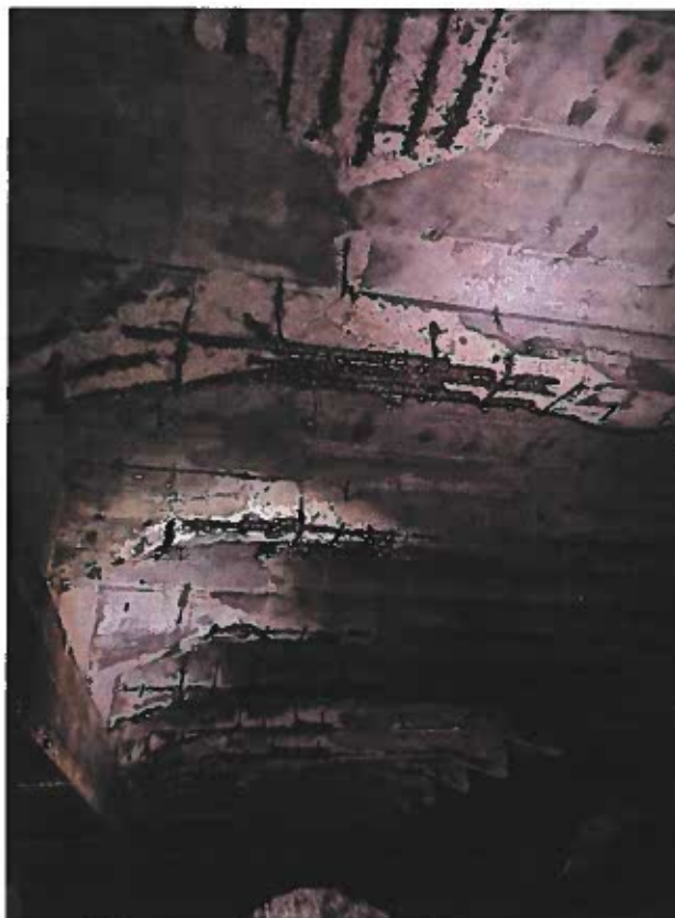
Foto 8. Degradări ale betonului din grinzi pe toată lungimea acestora: beton complet dislocat, măcinat, armături longitudinale și transversale la vedere, corodate, cu reducere severă a secțiunii, exfoliate, deformat, unele fără contact cu betonul, armături rupte. Grinda și-a pierdut forma geometrică inițială. Infiltrații și carbonatări la intradosul plăcilor de planșeu, armături fără acoperire, puternic corodate, cu reducerea severă a secțiunilor barelor. Beton cu aspect friabil
