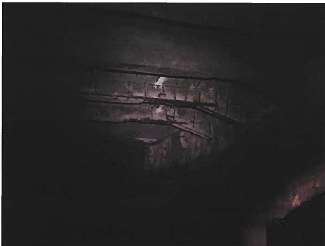
Foto 18. Degradări severe ale betonului din grinzi și din placa de planșeu, în unele zone în special în zonele cu vute ale grinzilor. Armături dezvelite complet și sever corodate, cu reduceri mari ale secțiunilor barelor
