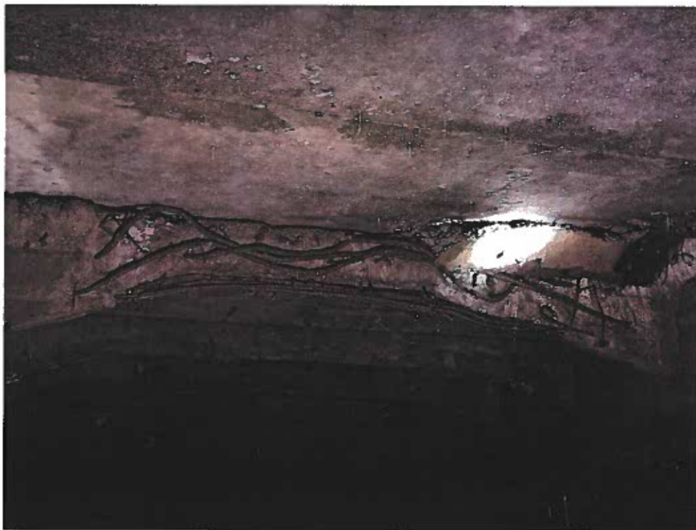
Foto 6. Degradări ale betonului din grinzile planșelului: beton complet dislocat, armături la vedere, corodate, deformat, unele fără contact cu betonul, armături rupte. Grinda și-a pierdut forma geometrică inițială. Beton desprins din placa planșelului
