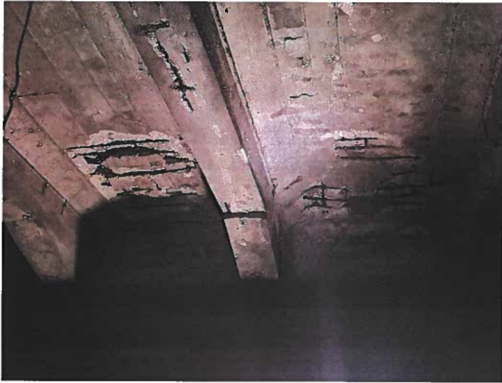
Foto 11. Aceleași degradări severe ale betonului la intradosul placilor de planșeu, în vecinătatea secțiunilor de rezemare pe cadre. Beton măcinat, desprins, armături la vedere, puternic corodate, cu reducerea puternică a secțiunilor barelor. Beton carbonatat la intradosul inimii grinzilor de planșeu
