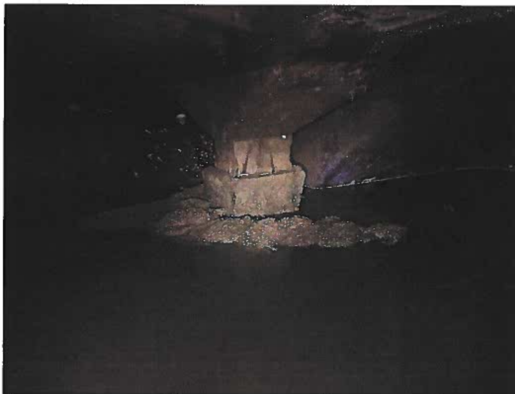
Foto 1. Stâlp de cadru cu degradări ale betonului: segregări, fisuri, crăpături, carbonatări. Material aluvionar depus în jurul stâlpului. Gunoaie adunate în spatele stâlpului. Betonul stâlpului prezintă degradări, urme ale unor fisuri/crăpături reparate. Cămășuiala de reparare a stâlpului este desprinsă
