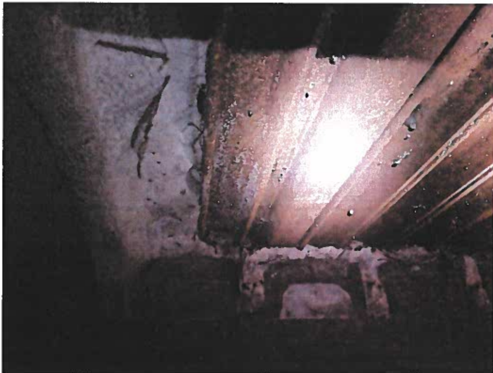
Foto 20. În unele zone placa de planșeu și grinzile au fost înlocuite cu tablă ondulată, fără nici o legătură/conexiune cu grinzile cadrelor
