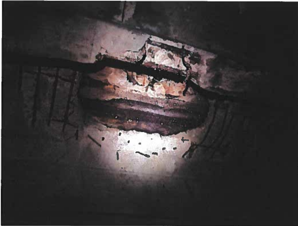
Foto 5. Degradări ale betonului la intradosul plăcilor de la planșeu. Beton dislocat, armături rupte, corodate, cu reducerea severă a secțiunii. Grindă cu betonul segregat, carbonatat, dislocat, cu armături rupte, corodate, la vedere
