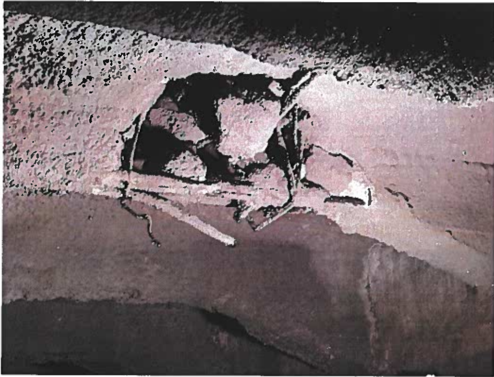
Foto 15. Grindă ruptă, cu betonul dislocat și armături rupte. Torcretul de reparație a fost aplicat pe secțiunea ruptă
