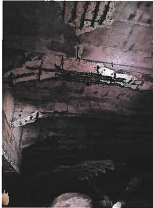
Foto 7. Degradări ale betonului din grinzi pe toată lungimea acestora: beton complet dislocat, măcinat, armături longitudinale și transversale la vedere, corodate, cu reducere severă a secțiunii, exfoliate, deformat, unele fără contact cu betonul, armături rupte. Grinda și-a pierdut forma geometrică inițială. Infiltrații și carbonatări la intradosul plăcilor de planșeu
