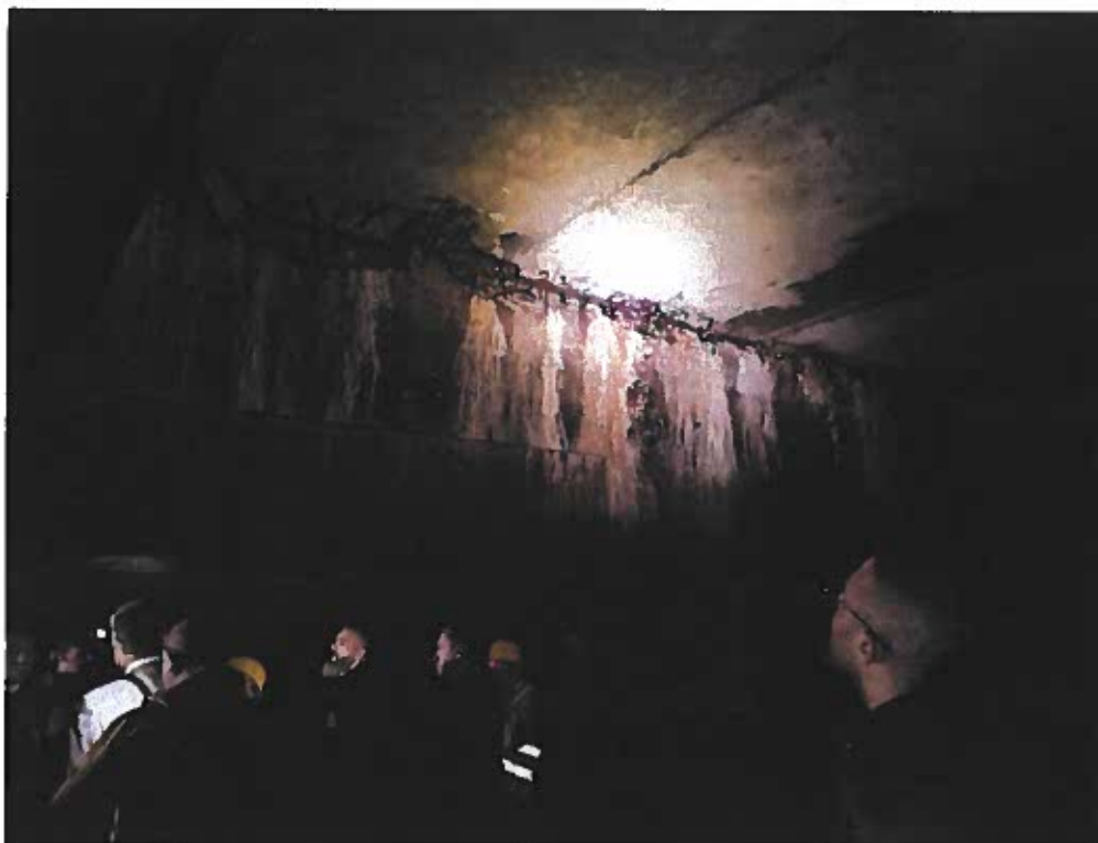
Foto 3. Vedere la intrados planșeu pasaj. Degradări ale betonului din dalele planșeului. Beton sever degradat la zona de îmbinare grindă de cadru plăcă planșeu. Armături la vedere și corodate, cu reducerea severă a secțiunii. Beton dislocat
